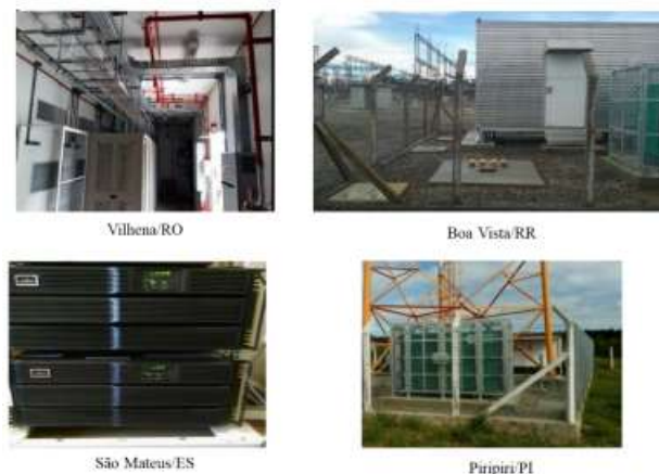
Figura 7 - Estação de Monitoramento
