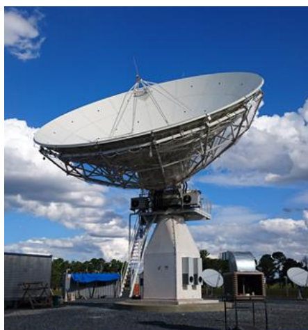
FIGURA 2 - Antena de Comunicação da Estação de Acesso
