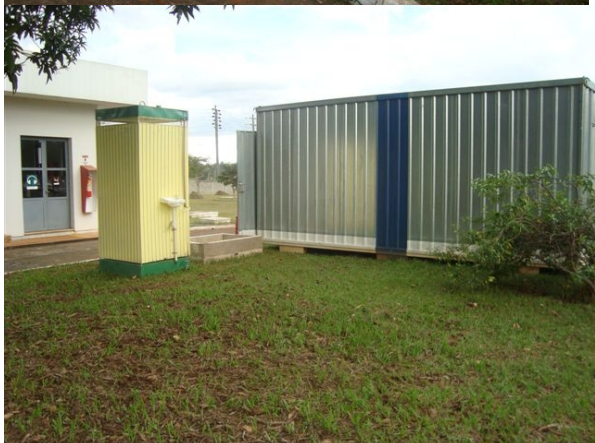
Subestação de Brasília Geral - Furnas
